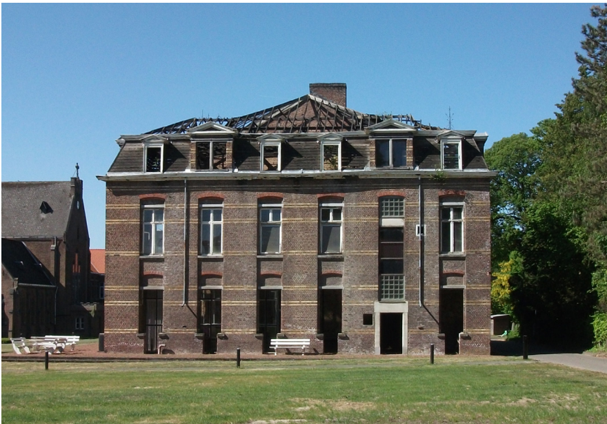
På avstånd kan man än idag uppfatta byggnaden som övergiven vid första anblick. Taket består endast av takstolar, och saknade fönsterrutor blir gapande mörka hål i fasaden.
